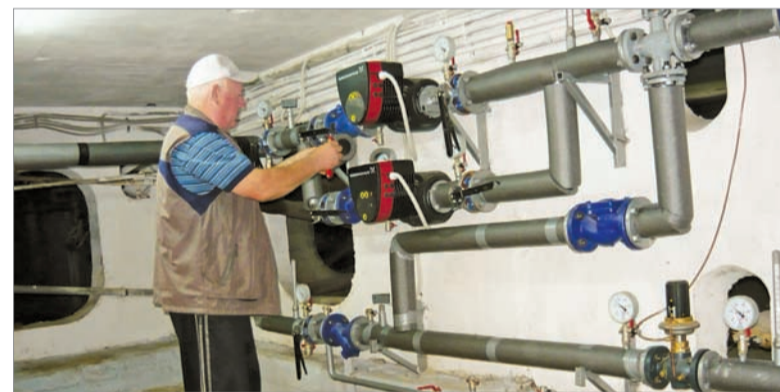
Новые теплоузлы в доме на ул. Профсоюзной, 16/2, позволят экономить и тепло, и деньги жильцов
