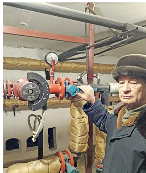
Зимой управляющий ТСЖ «Иркутское» Юрий Мухин ежедневно следит за работой теплового оборудования
